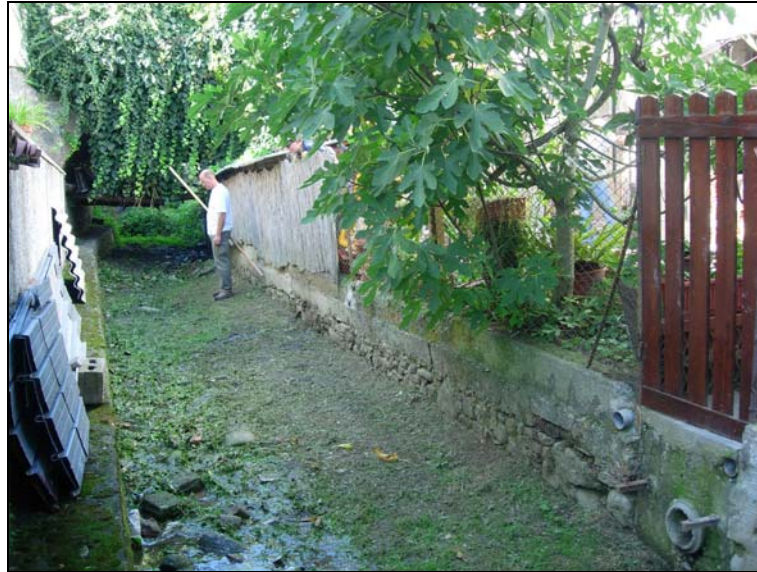
Figura 5-7 Rio Zanesi - RS 90 (vista verso monte) si nota in sinistra idraulica il muro di sponda insufficiente, mentre in destra un muro di sponda ben più alto.
