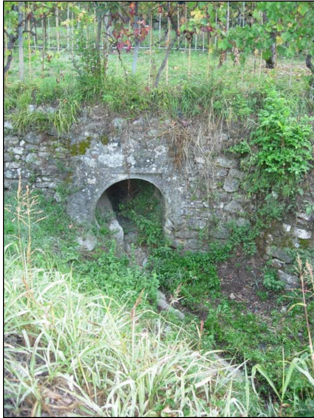
Figura 4-12 Solco di Santa Maria RS70 - uscita della tubazione \Phi 100 (vista verso monte)
