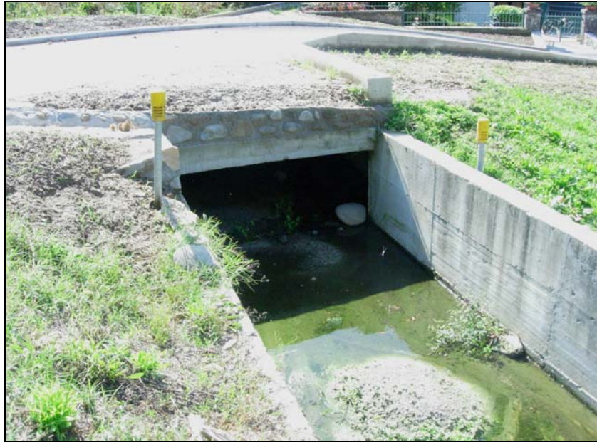
Figura 4-8 Rio del Catarozzo RS 15 (vista verso valle) in lontananza si può osservare il punto di immissione nel Rio Giuvicchia.
