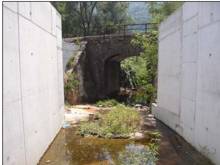
Figura 4-27 Rio del Chitarrino RS 30 in lontananza si nota il ponte della ferrovia (vista verso valle)
